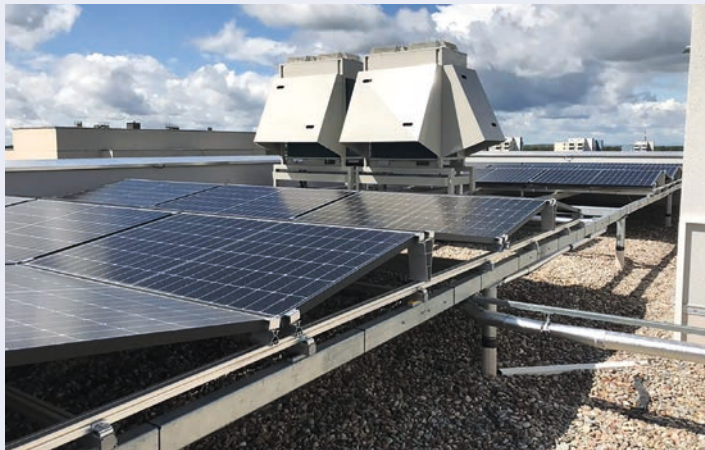
Photovoltaikanlage und zwei Wärmepumpen auf dem Dach
