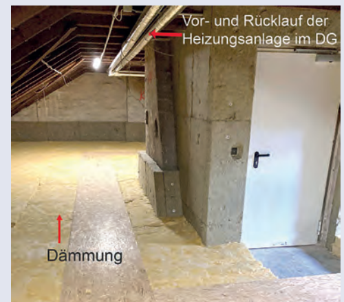
Heizungsverteilsystem jetzt im DG
