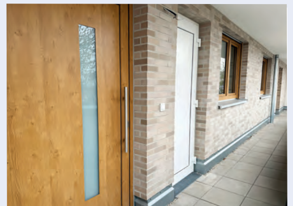
Laubengang mit WE-Tür und Technikzentrale
